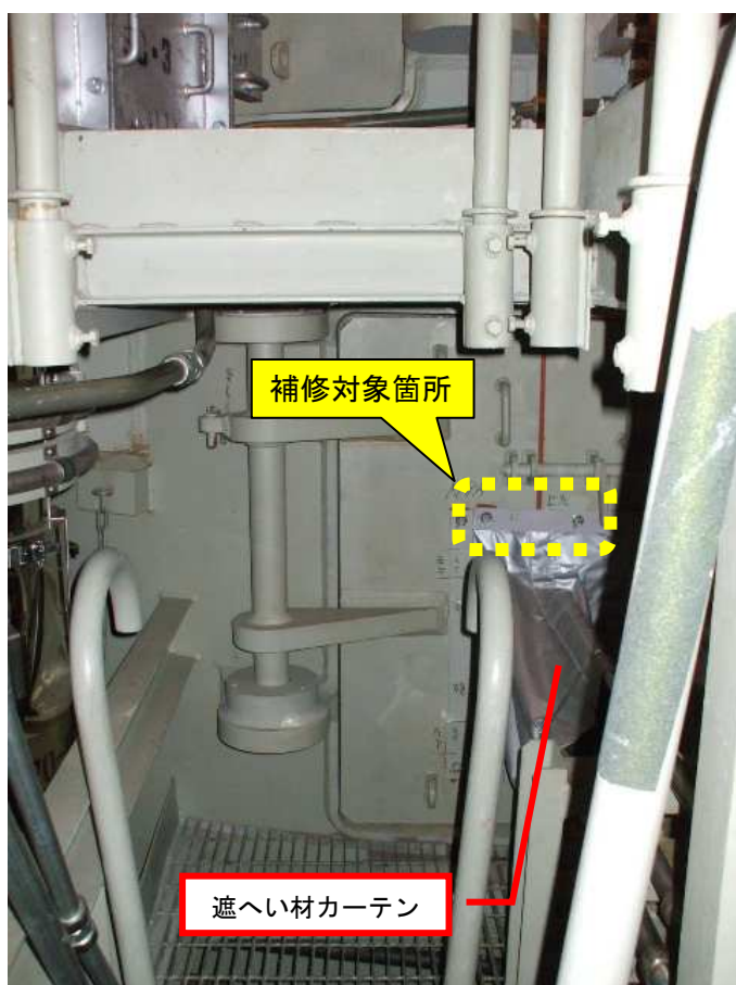
ジェットポンプ計装ノズル部遮へい扉
