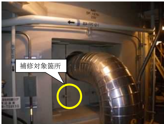
原子炉給水ノズル部遮へい扉 (代表例)
