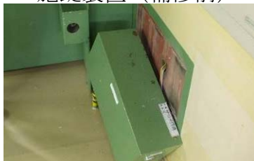
施錠装置（補修前）
