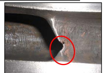
ケーシング減耗状況写真 (約4mm)
