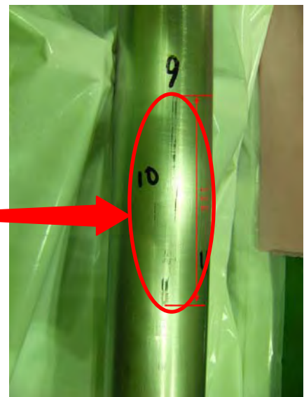
当該弁(A) 弁棒の傷状況
