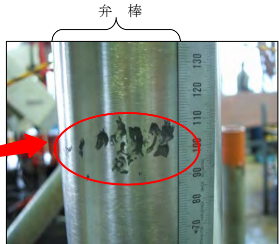
当該弁 弁棒腐食状況写真
