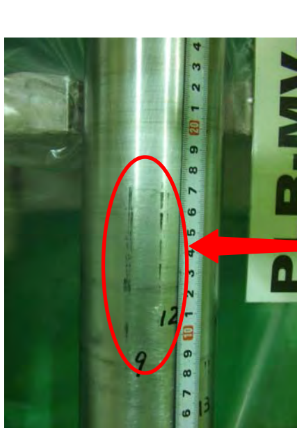
当該弁(B) 弁棒の傷状況
