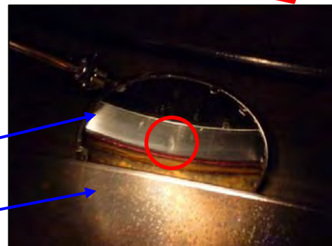
弁座シート面へこみ状況写真
