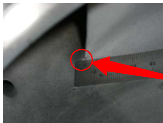
当該羽根車 線状指示模様状況写真
