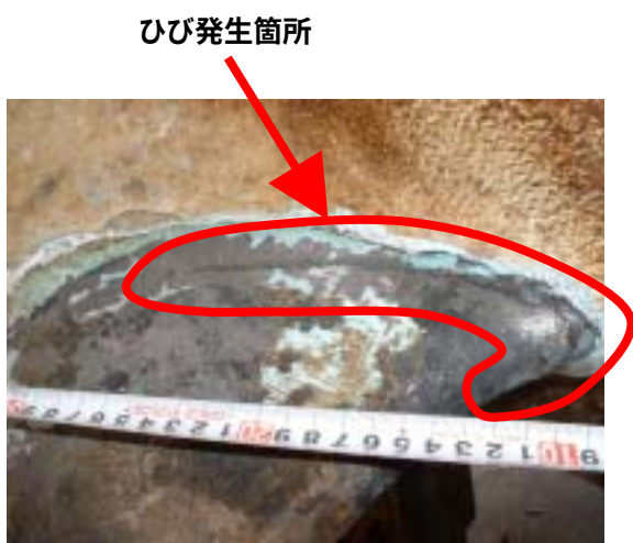
循環ポンプ整流板 ひび写真
