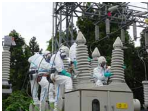
66kV遮断器点検
