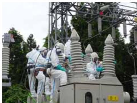
66kV遮断器点検
