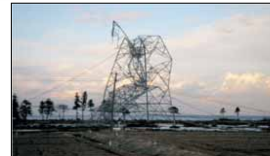
折損した送電鉄塔(福島県)
