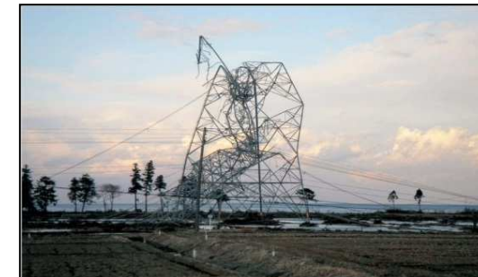
折損した送電鉄塔(福島県)
