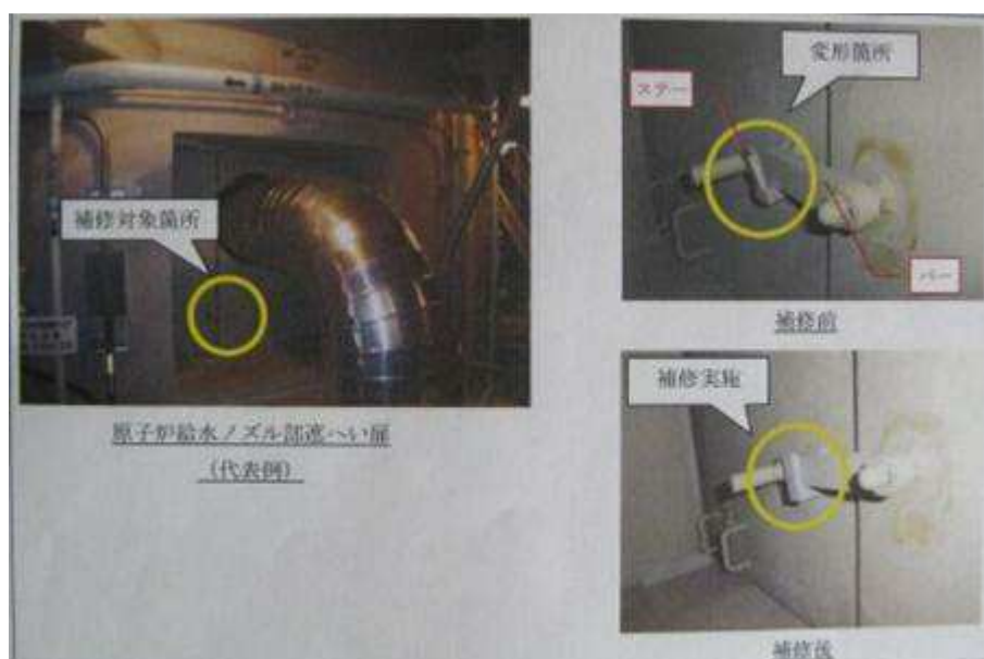
図 7-26 ハッチの鋼製ラッチでの曲がり
