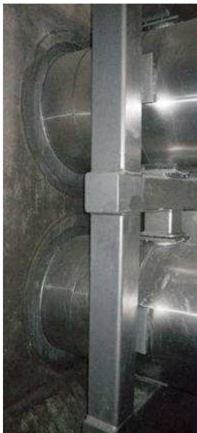
図 7-35 RSW ピットから RSW トレンチへの配管貫通部 2号機で樹脂シール（壁貫通部と RSW 配管の間のダークグレイの環）が 3/11 の津波の後設置された
