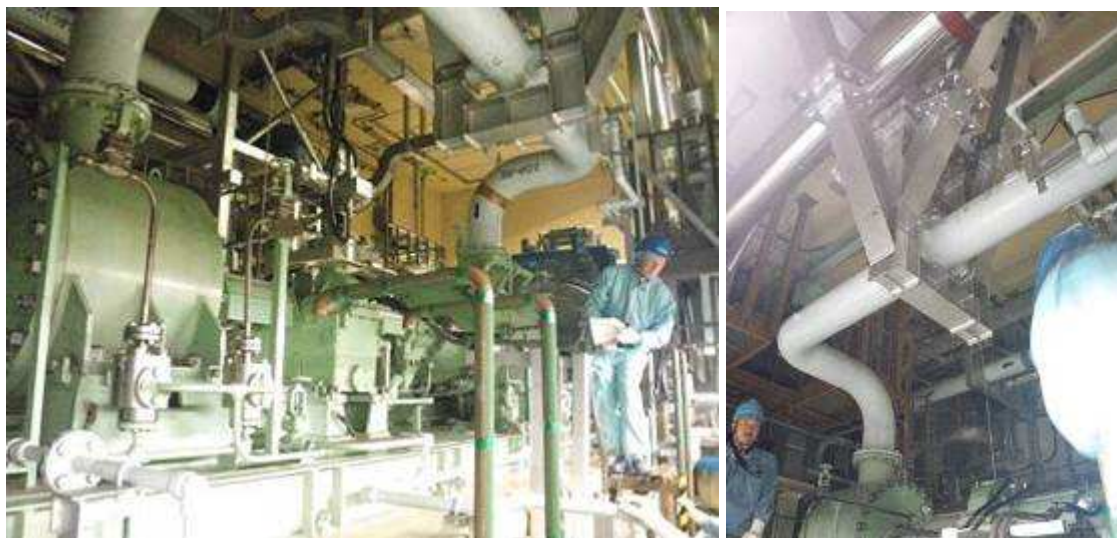
図 7-3 1号機高压炉心注入ポンプ（左）とその配管サポート（右）
