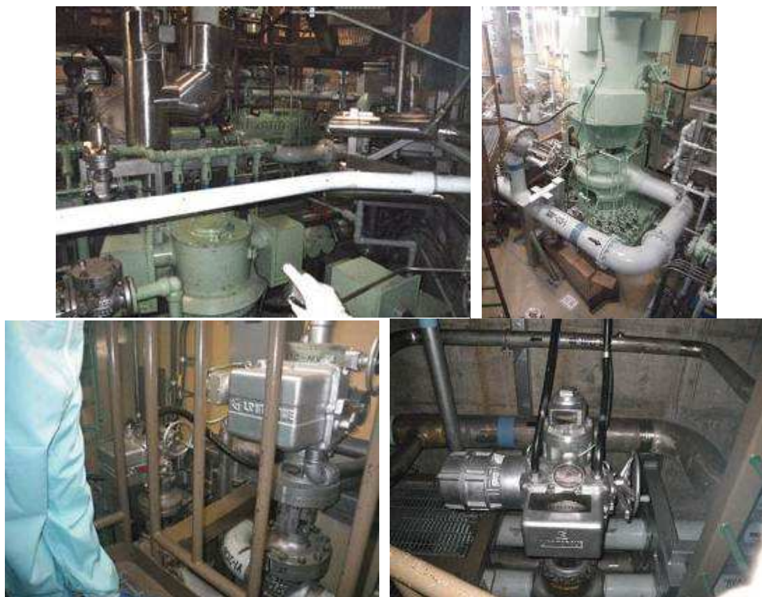
図7-2 RCIC 蒸気駆動ポンプ（左上），低圧炉心スプレイポンプ（A）（右上），これら系統の電動弁（下）
