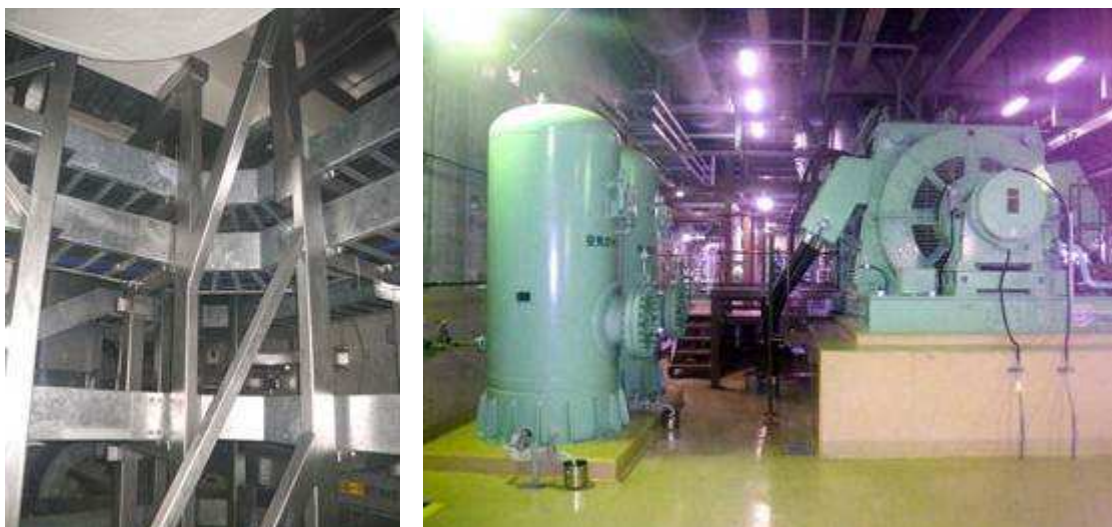
図 7-5 ケーブルトレイサポートの例（左）と非常用ディーゼル発電機（右）
