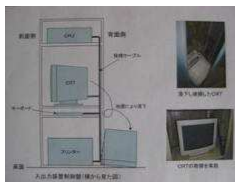
図 7-24 固定されていない機とラック設置設備
