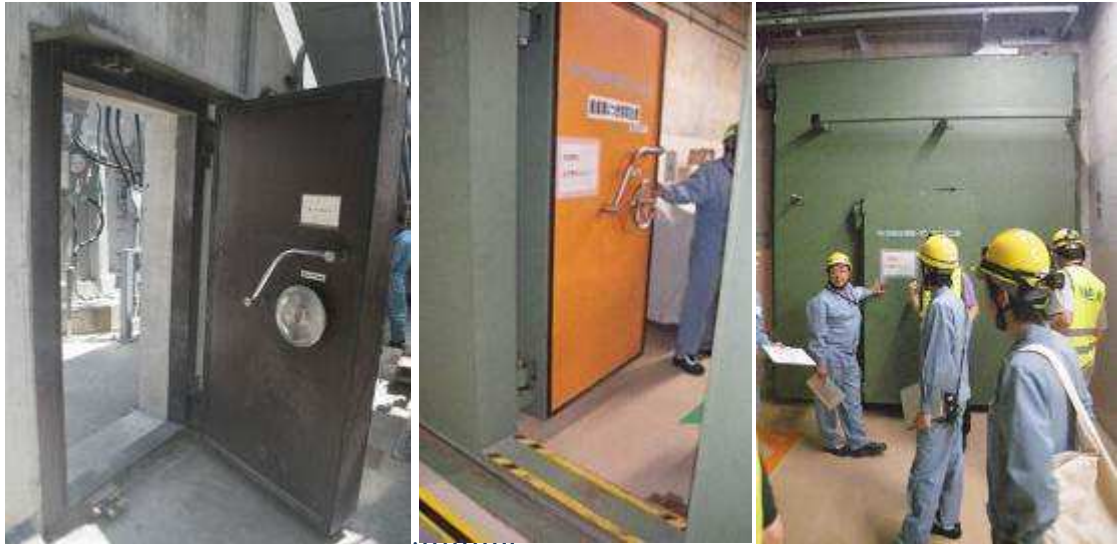
図 7-36 2号機の水密扉 海水ポンプピット（左），RCW 熱交換器室（中央，右）
