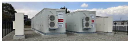
弥藤吾蓄電所 (提供:坂東蓄電所1号合同会社)
