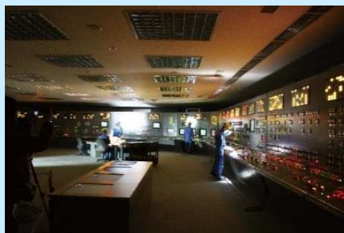
全交流電源喪失を想定した運転訓練 (運転シミュレータ訓練施設)
