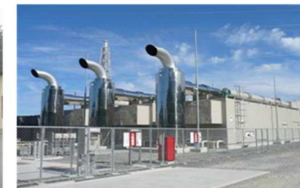
大容量電源装置(高台に設置)
