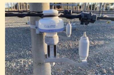
配電線の耐雷対策
