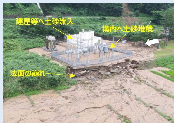
発電所構内への土砂流入
