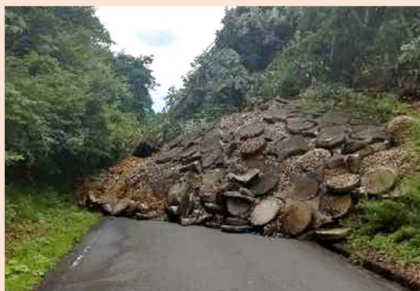
土砂崩れによる道路の寸断
