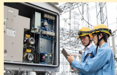
変電設備の巡視・点検
