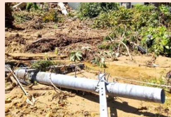
河川氾濫による電柱の流出
