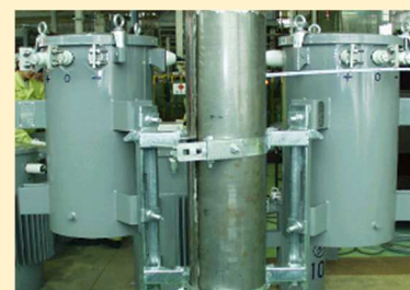
配電変圧器の耐震対策(ハンガ化)
