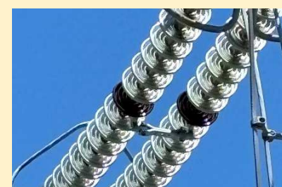
架空送電線への地震対策
