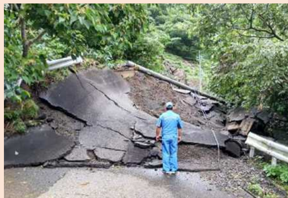
土砂崩れによる電柱の流出
