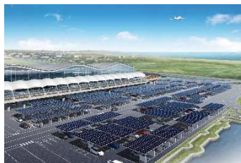
(提供元：仙台空港再エネ発電合同会社) オンサイトPPAの例：仙台空港のカーポート型太陽光発電所
