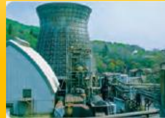
松川地熱発電所 (岩手県八幡平市)
