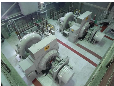
水車発電機外観 (手前より2号機、1号機)
