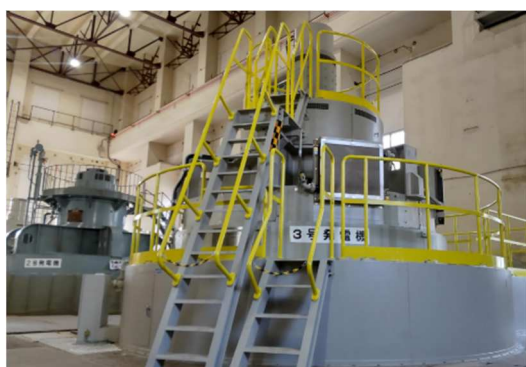
発電機外観（手前より3号機、2号機）
