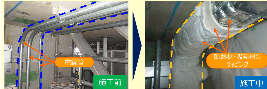
【追加で実施している「電線管への耐火材ラッピング工事」】
