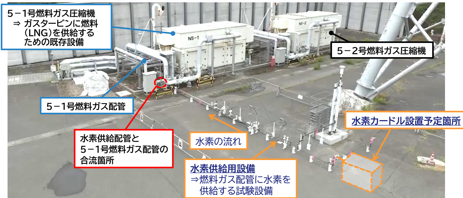
設置中の水素供給用設備の状況
