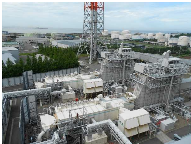
新潟火力発電所 5号系列
