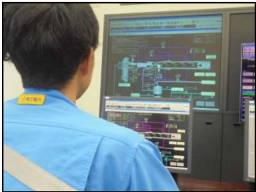
運転状況を監視し、運転データの変化などから、異常がないか確認
