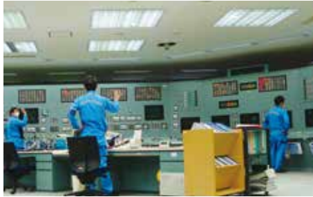
発電所の頭脳にあたる中央制御室
