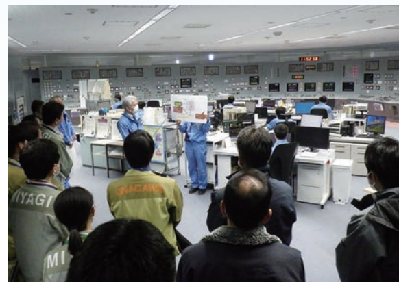
2号機中央制御室で現場確認を行う 自治体関係者
