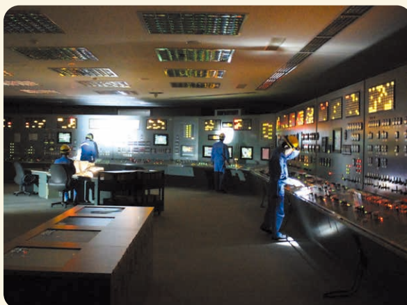
全交流電源喪失時を想定した運転訓練（運転シミュレータ訓練施設）
