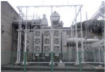
主変圧器（撤去前）
