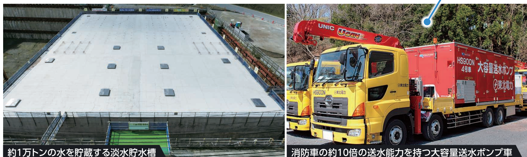
約1万トンの水を貯蔵する淡水貯水槽
