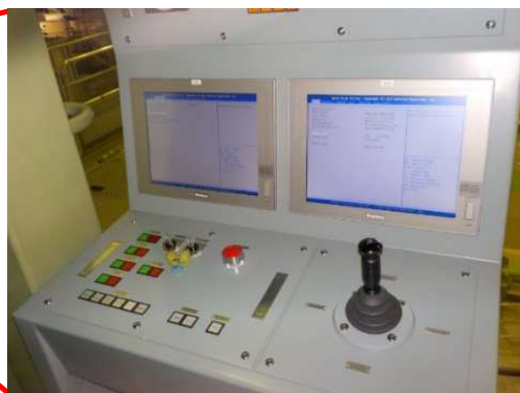
機上操作卓パネルコンピュータ
