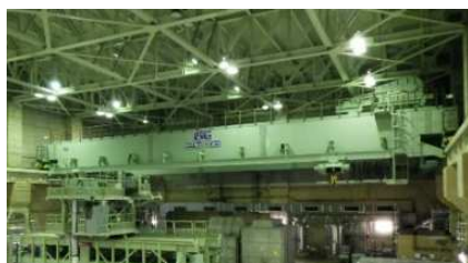
天井クレーン全景(写真)
