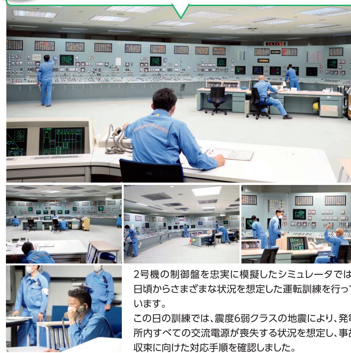
シミュレータによる運転操作訓練
