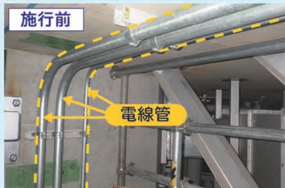
難燃性の電線を金属素材の電線管で覆っている
