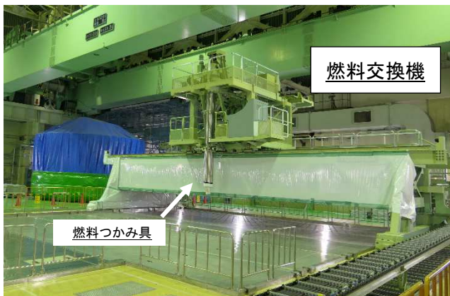
燃料交換機 全景写真
