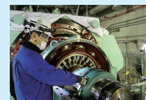
非常用ディーゼル発電機
