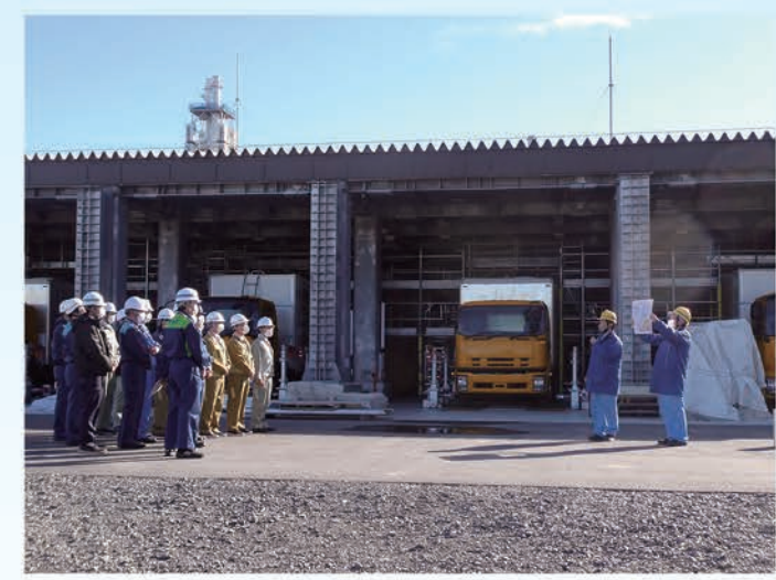
安全対策工事の状況(ガスタービン発電設備)について説明を受ける自治体関係者
