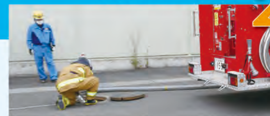
消火活動に使用する水を地下の防火水槽から取水するため、水槽と消防車をホースで接続
