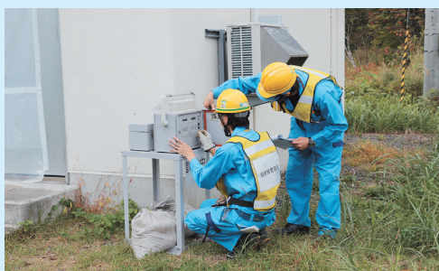
可搬型モニタリング設備の設置訓練
