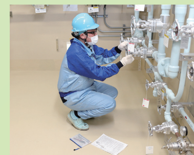
慣れた作業でも操作個所に誤りがないか慎重に事前確認
