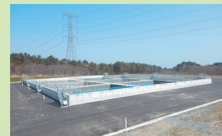
淡水貯水槽 重大事故などの収束に必要な冷却水を約7日間分確保するため、約1万トンの水を貯めておくことができます。
