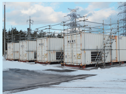
大容量電源装置外観
