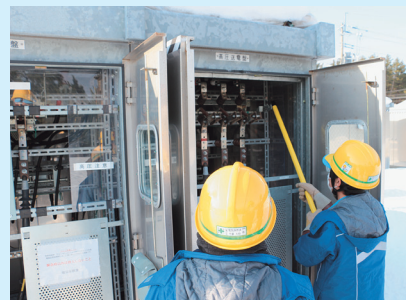
大容量電源装置の送電盤を操作
