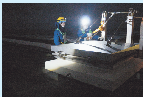
原子炉建屋ベント装置の模擬開放操作
