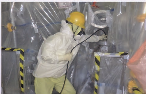
高圧洗浄装置を用いて配管に付着する放射性物質を除去する様子
