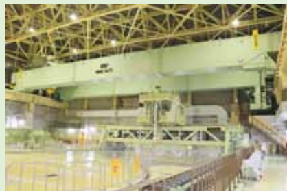
原子炉建屋クレーンの全景
