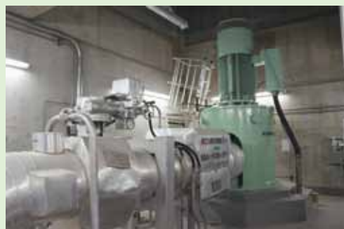
原子炉補機冷却海水ポンプ
