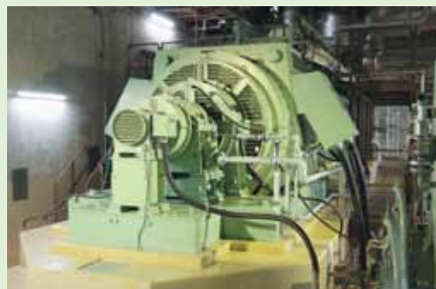
非常用ディーゼル発電機
