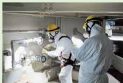
燃料タンクの弁を操作
