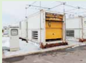
大容量電源装置
