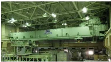
天井クレーン全景(写真)
