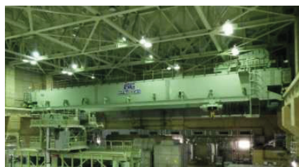
天井クレーン全景(写真)
