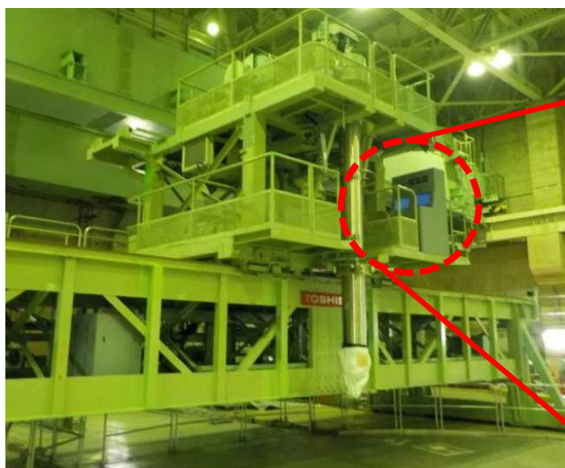
1号機 燃料交換機全景
