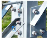
ボルト脱落穴の検出
