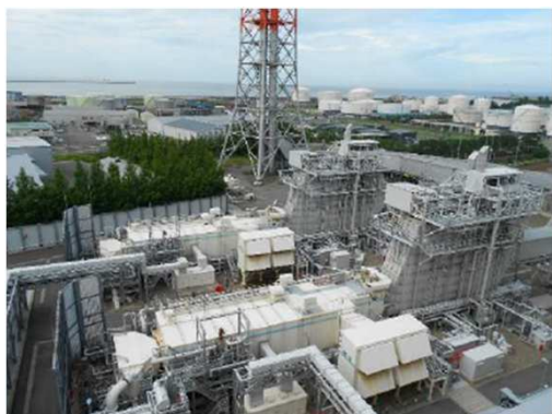
新潟火力発電所5号系列
