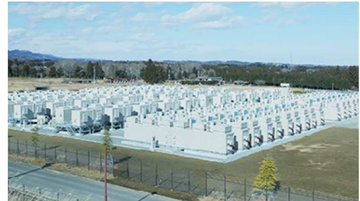
南相馬変電所大容量蓄電池システム外観
