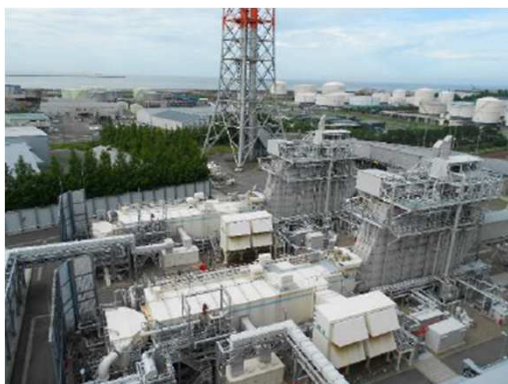
新潟火力発電所 5号系列
