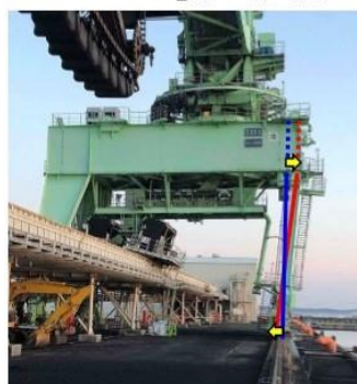
揚炭機脚部損傷状況
